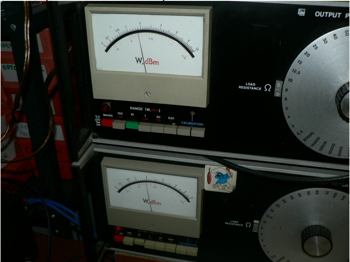
Pomiar mocy, a właściwie równomierności przenoszenia kanałów.
